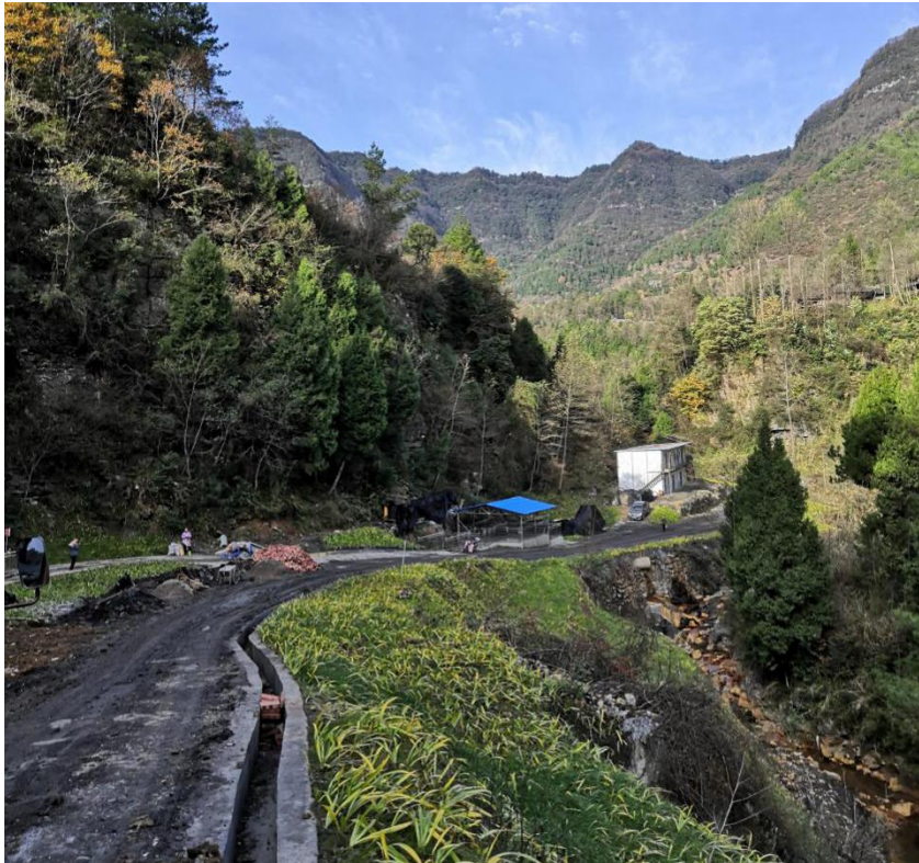
照片 3-3 乡村公路外侧斜坡受冲刷
