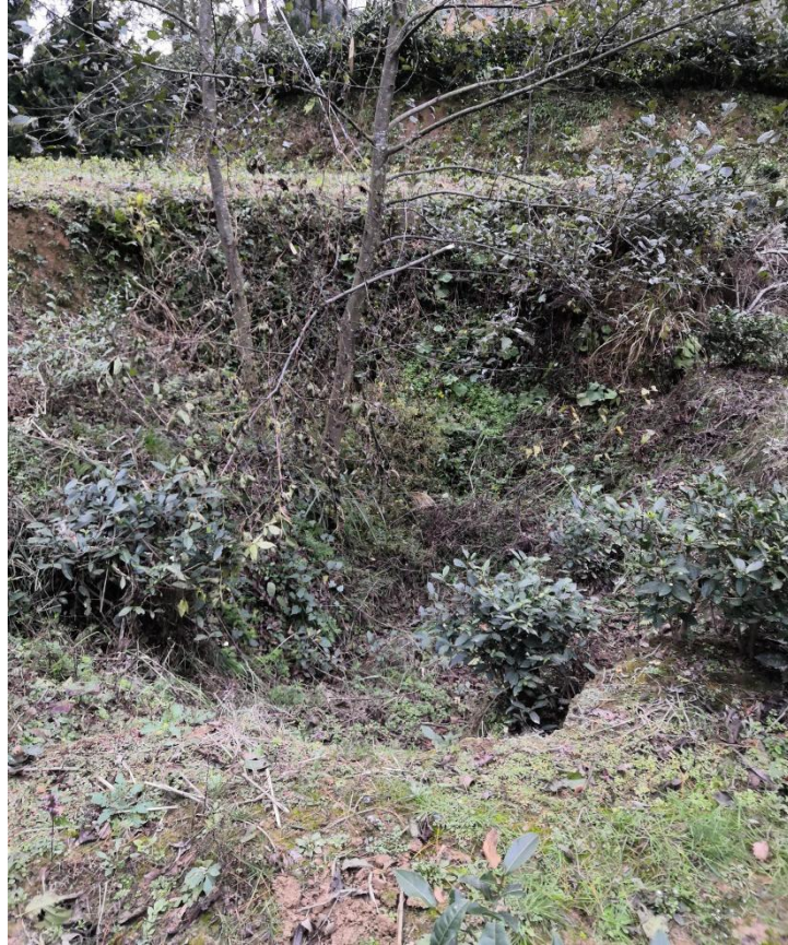
照片 3-5 2#塌陷 (TX02) 概貌
